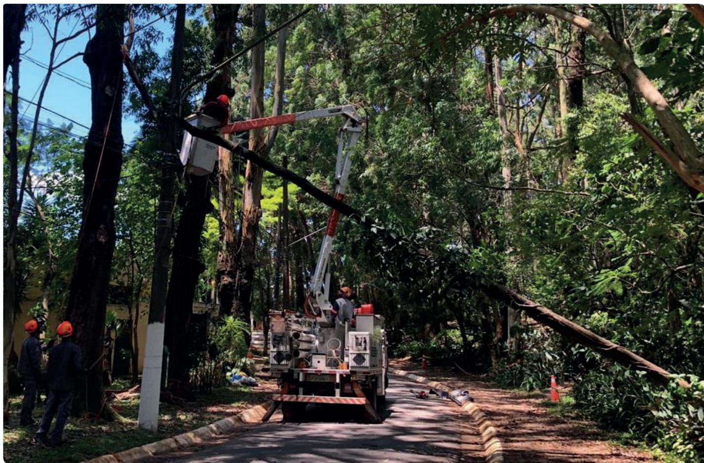
Equipe remove árvore caída sobre poste em 2019
